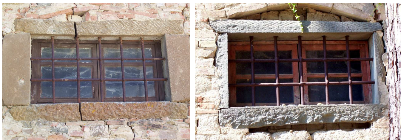
Fig. 33 - Due immagini tratte dallo stesso edificio nelle pertinenze della Villa di Sticciano: a sinistra architravi realizzati con sabbie Plioceniche, che mostrano una evidente frattura. A destra, più solidi architravi realizzati in pietra serena.
